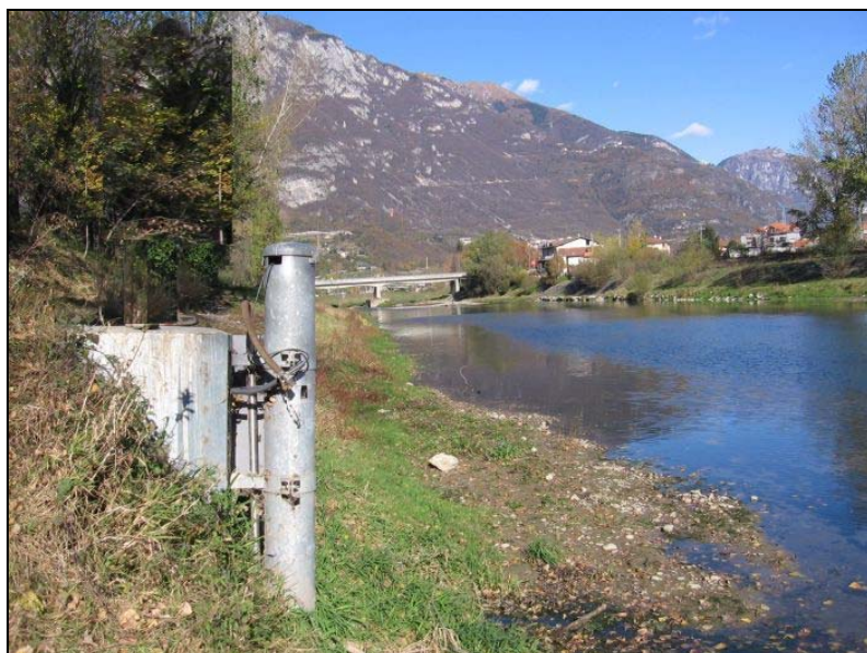
Foto 2 – Stazione di Costa Volpino; opera di presa.
