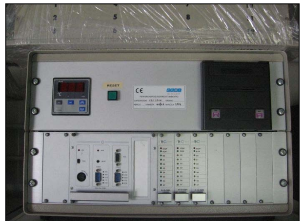
Foto 9 - Collegamento alla rete ENEL attivo.
