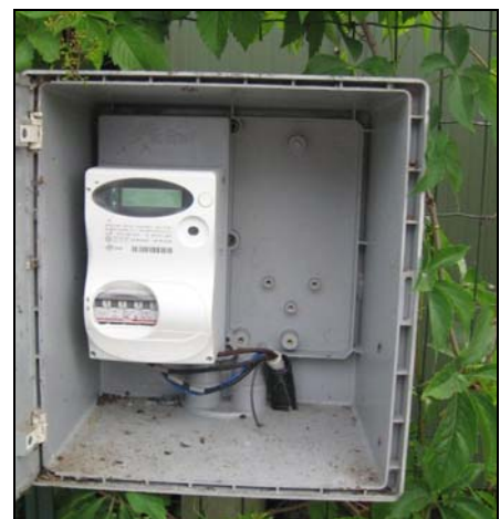
Foto 4 - Collegamento alla rete ENEL attivo.
