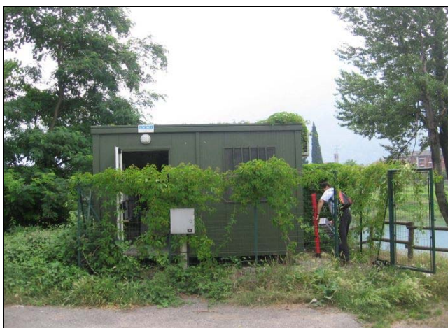
Foto 3 - Cabina e recinzione esterna.
