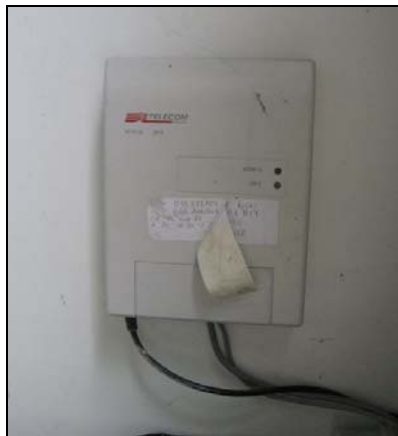
Foto 7 - Modem Telecom per la teletrasmissione dei dati.
